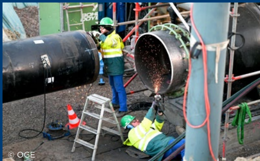
Letzte Schweißarbeiten für die Anbindung der WAL an die Norddeutsche Erdgas-Transversale (NETRA).
